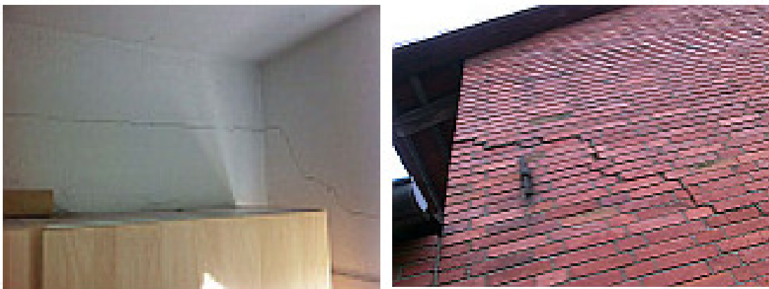
Gebäudeschäden nach Beben (2,9) im Feld Völkersen der RWE Dea. Links: Haus von MdB Mattfeldt.
