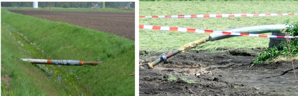
Beschädigte Nassöl-Leitungen ohne vorgeschriebenen Schutz
