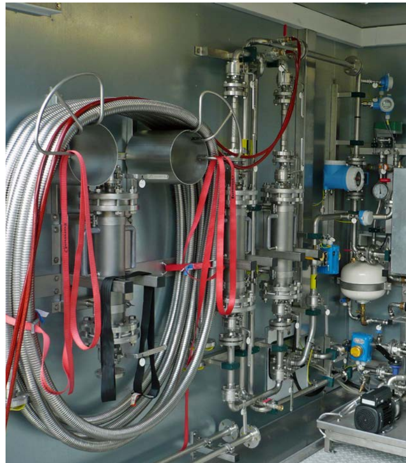
Im Forschungsprojekt BioKS wird mit Hilfe eines mobilen Bypasses untersucht, wie mikrobielle Besiedelungen zur Korrosion in Geothermieanlagen beitragen.
