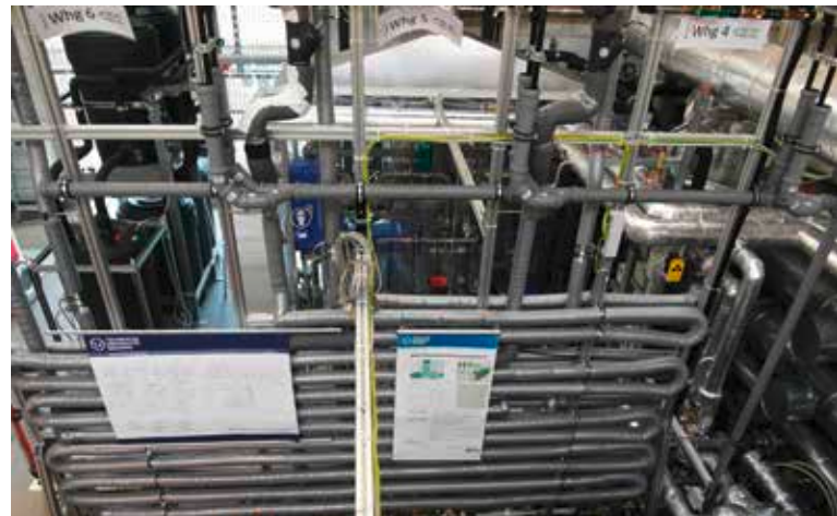
Versuchsanlage der Technischen Universität Dresden, Professur für Gebäudetechnik und Wärmeversorgung
