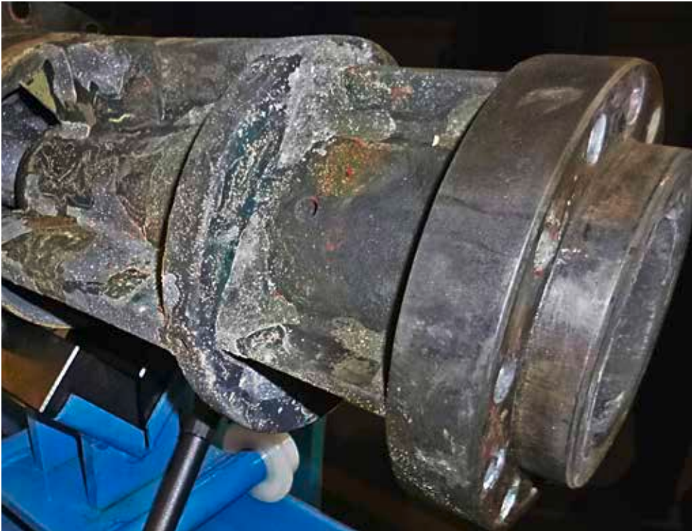
Typische Kalkablagerungen am Pumpeneinlass
