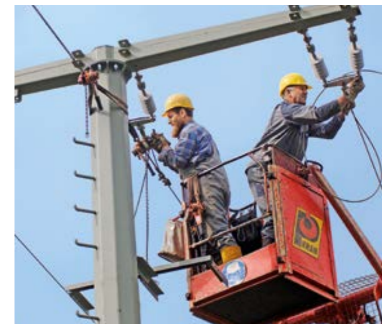
Die Netzanbindung stellt eine Herausforderung dar.
