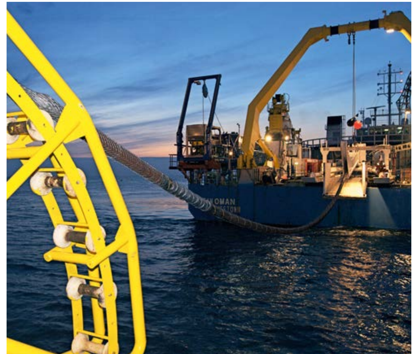
Über Seekabel werden Offshore-Windenergieanlagen an das Übertragungsnetz auf dem Festland angeschlossen.
