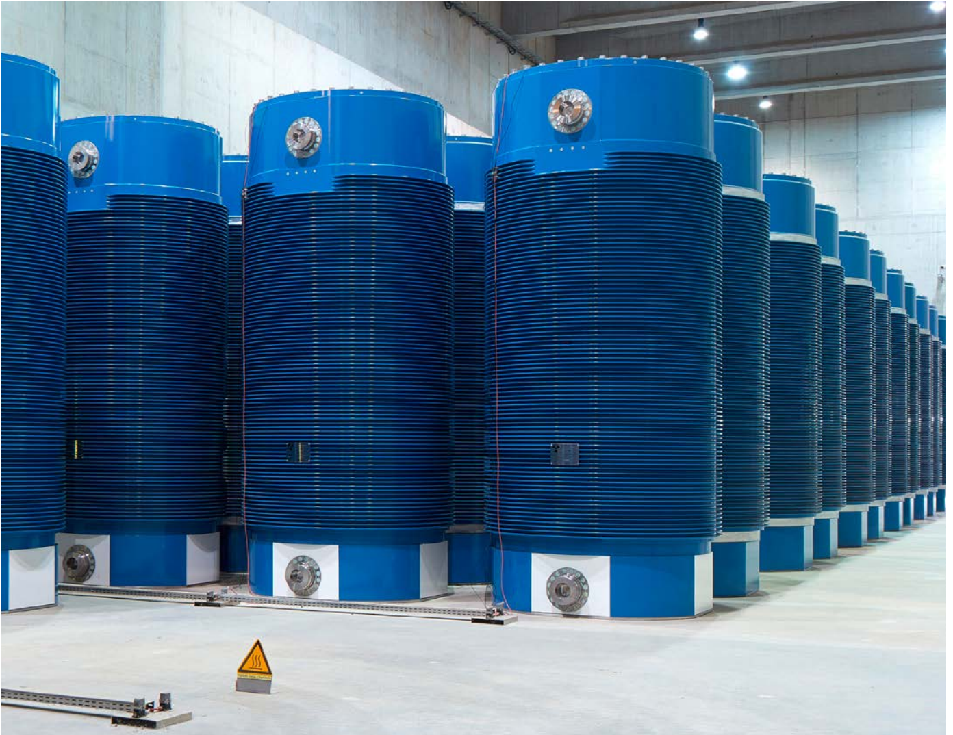
Blick auf die im Zwischenlager Gundremmingen eingelagerten Transport- und Lagerbehälter für hochradioaktive Abfälle (TLB)
