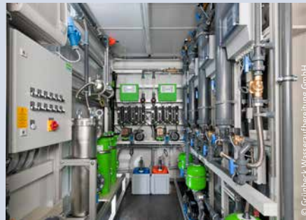
Anlage zur Trinkwasseraufbereitung
